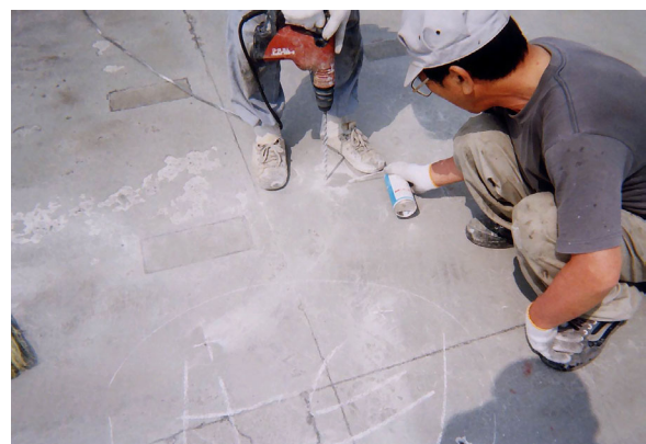
漏水箇所削孔状況
