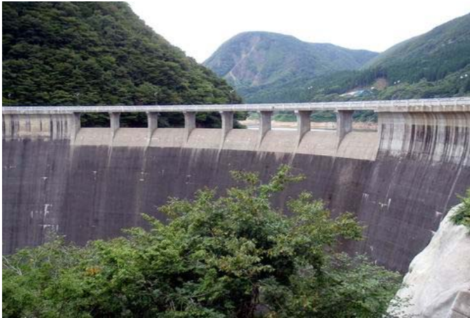
堤頂（上流側・下流側・高欄打継ぎ部）・越流部 施工完了
