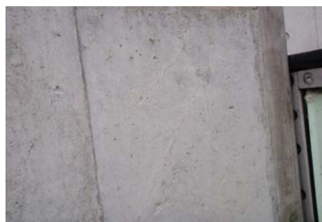
ひび割れ補修箇所
