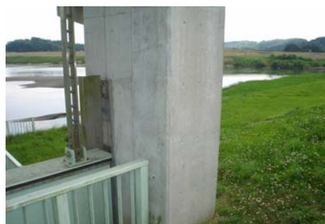
ひび割れ補修箇所
