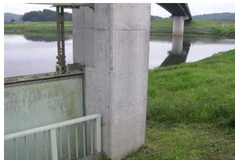
ひび割れ発生状況
