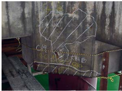
ひび割れ・浮き箇所確認状況
