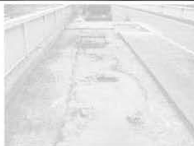
橋大橋の床版劣化
